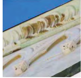
↑ Particolare dei degni della mensola sottogronda. Detail of the degradation of the ledge under the eaves.
