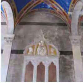
↑ Macchie ed efflorescenze negli intonaci interni. Stains and efflorescence in interior plasterwork.
