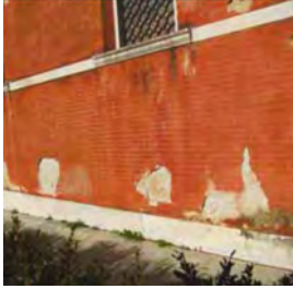
↑ Distacco dell'intonaco esterno. Detachment of the external plaster.
