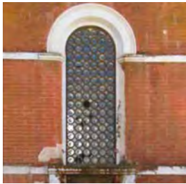
↑ Degrado degli infissi. Degradation of the fixtures.
