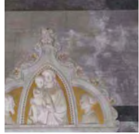
↑ Macchie ed efflorescenze negli intonaci interni. Stains and efflorescence in interior plasterwork.
