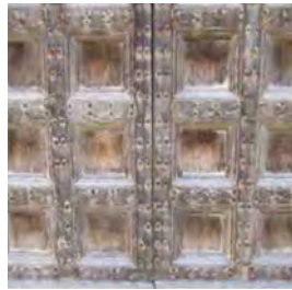
↑ Degrado degli infissi. Degradation of the fixtures.
