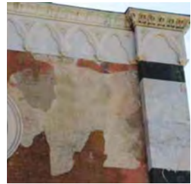
↑ Distacco dell'intonaco esterno. Detachment of the external plaster.
