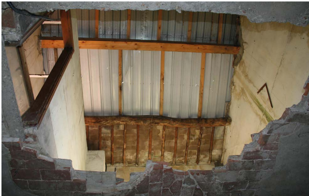
Casale Conte Ranieri Vista della copertura in lamiera grecata e della volta sottostante, parzialmente crollata
