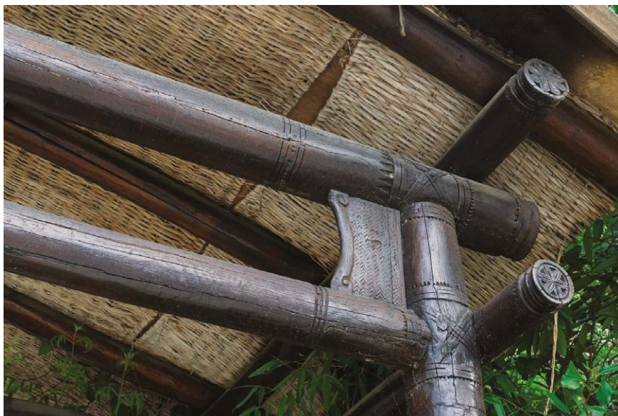
Figura 2 – Dettaglio del nodo strutturale del tetto: stuoie giapponesi decorano l'intradosso del tetto. Foto © Yiagos Athanassopoulos.
