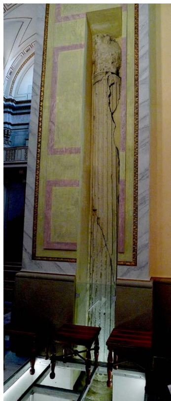
Figura 2 – Resti di una delle colonne inserite nei pilastri della chiesa di S. Pancrazio.
