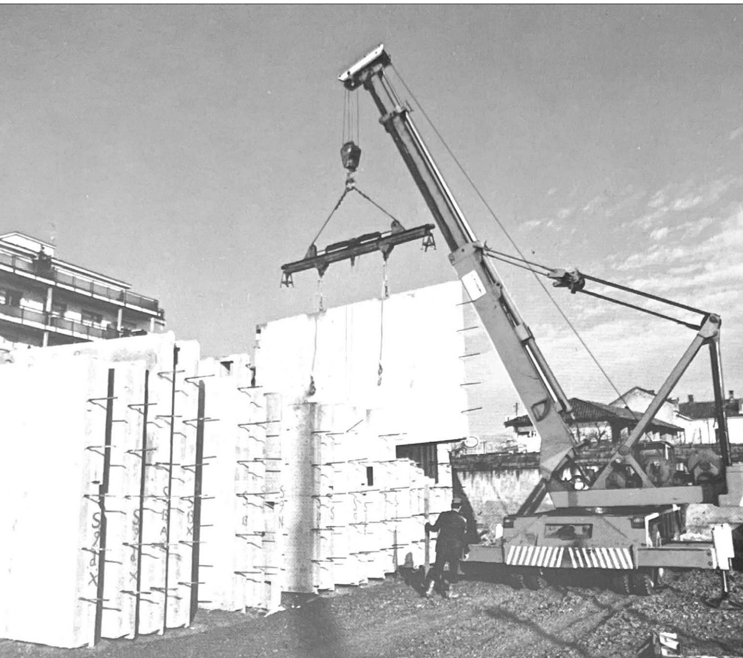
Figura 2.7 – Giova osservare che l’adozione di casseri basculanti, ovvero sollevabili in posizione sub-verticale per favorire l’aggancio del bilancino metallico, e quindi il distacco dei bordi dello stampo, funzionale al trasporto a stoccaggio tramite gru (Fig. 2.7), avvantaggia le verifiche da effettuare sul pannello, non essendo sottoposto a ribaltamento in fase di produzione, come già previsto dal procedimento Baretts. Il trasporto dei pannelli avviene su camion specificamente attrezzati, quindi posati in opera mediante gru o autogru. Il montaggio prevede l’appoggio dei componenti su tacchette di rife-
