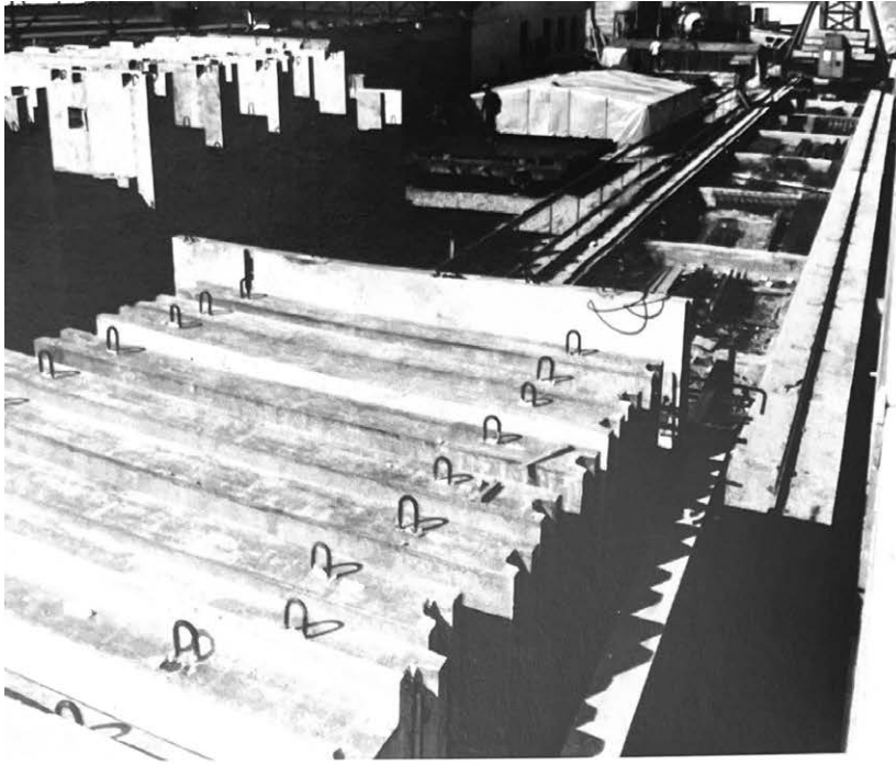
Stoccaggio degli elementi prefabbricati con cappa per la maturazione a vapore visibile sullo sfondo.
