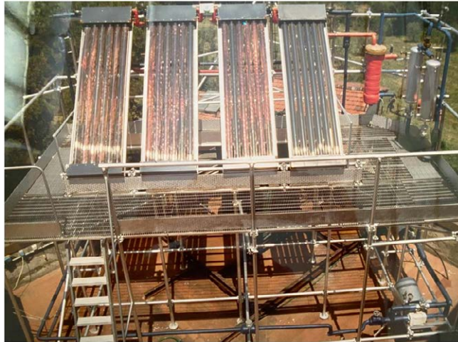
Figura 115 – Banco prova collettori solari evacuati sul terrazzo della sede di S. Marta.
