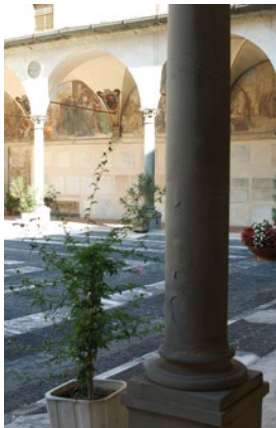
Fig. 8 Chiostro dei morti (XVI sec.) nel complesso conventuale della Santissima Annunziata: fenomeni di esfoliazione nelle colonne in Pietra Serena.
