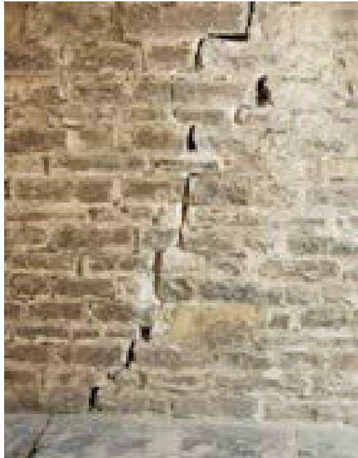
3. Firenze, Palazzo Vecchio, Camminamento coperto: lesioni prima dell'intervento 3. Florence, Palazzo Vecchio, Covered parapet walk: damage prior to the restoration
