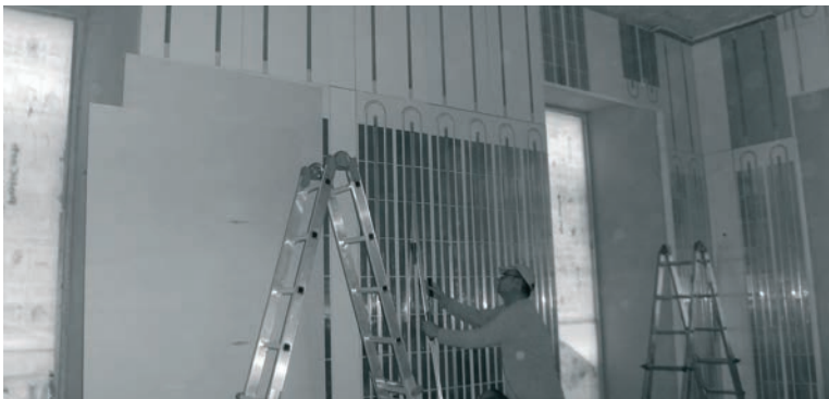
Installazione dei componenti del sistema isolante e radiante nella stanza campione. / Anchoring of the components of the insulating and radiant system in the experimental room.
