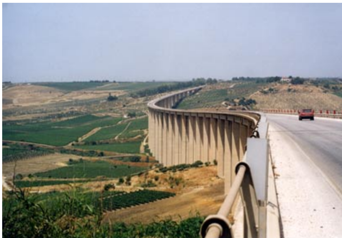
Figura 14. Un viadotto della strada statale n. 115 tra Castel Vetrano e Menfi (Sicilia) che attraversa con imponenza una valle agricola
