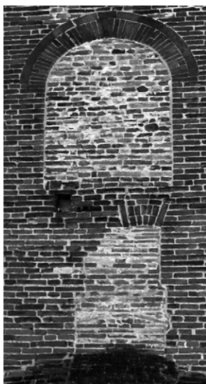
Fig. 34 – Alcune aperture tamponate sul campanile della Pieve di San Lorenzo a Borgo San Lorenzo (FI) a causa di una lesione verticale che interessa l'intero prospetto.
