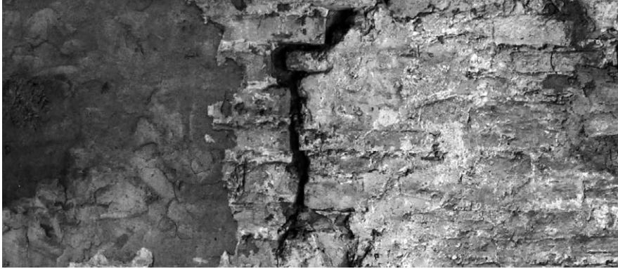
Fig. 6 – Esempio di interfaccia stratigrafica interessata da un distacco che ha provocato la formazione di un evidente quadro fessurativo di un paramento interno del campanile della Pieve di San Lorenzo a Borgo San Lorenzo (FI).
