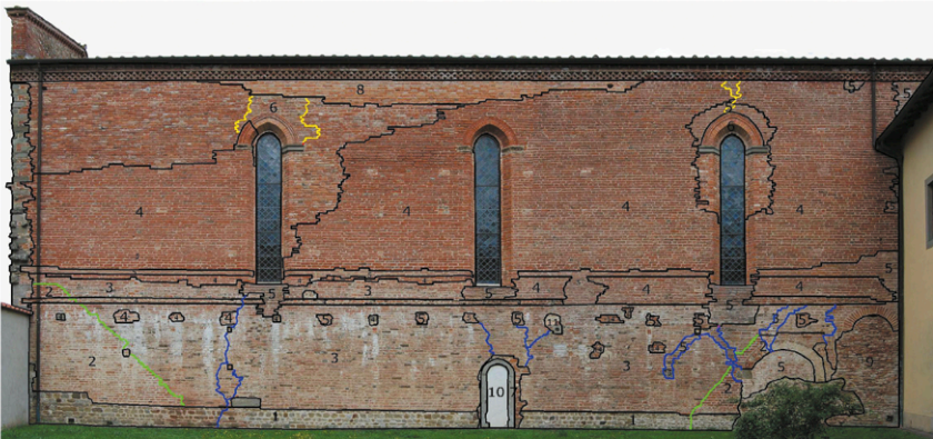
Lettura stratigrafica e caratterizzazione periodizzata del quadro fessurativo del prospetto sud della chiesa di San Francesco a Borgo San Lorenzo (FI). Le lesioni ai margini del prospetto di colore verde sono riferibili ad un periodo anteriore al 1542; quelle verticali nel centro del paramento di colore blu si riferiscono al terremoto del 1542; quelle nei pressi del tetto di colore giallo appartengono al terremoto del 1919.
