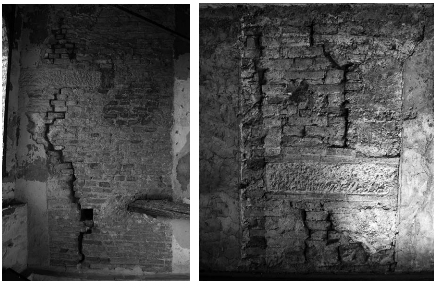
Fig. 8 – Due esempi di ammorsature di lesioni effettuate attraverso l'impiego di catene in pietra poste all'interno del campanile della Pieve di San Lorenzo a Borgo San Lorenzo (FI).
