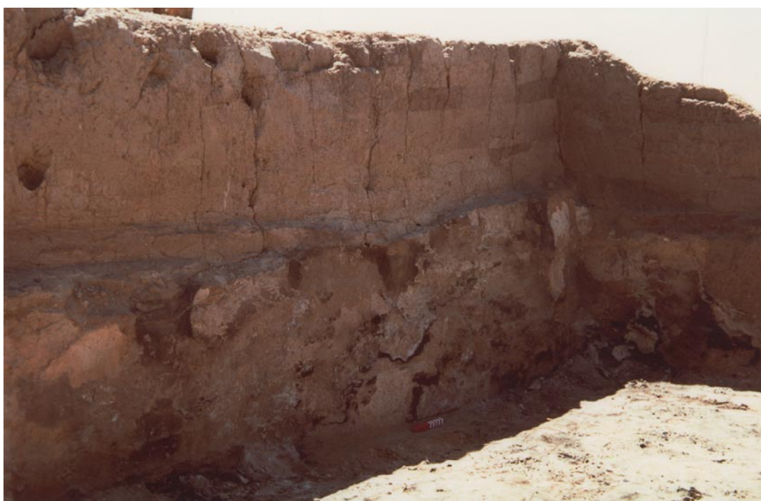
La sala 190 con i muri rivestiti di uno spesso intonaco decorato a bande. Sul pavimento, in argilla battuta, si vedono i segni lasciati dall'incendio del primo piano che è crollato quando oramai l'edificio era fuori uso. Si noti il rialzamento dei muri effettuato in età neobabilonese, dopo lo spianamento dell'area del palazzo.
