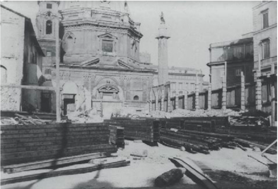
Fig. 20. La Piazza della Madonna di Loreto durante la construcción del Palazzo Generali. 18 de agosto de 1904.
