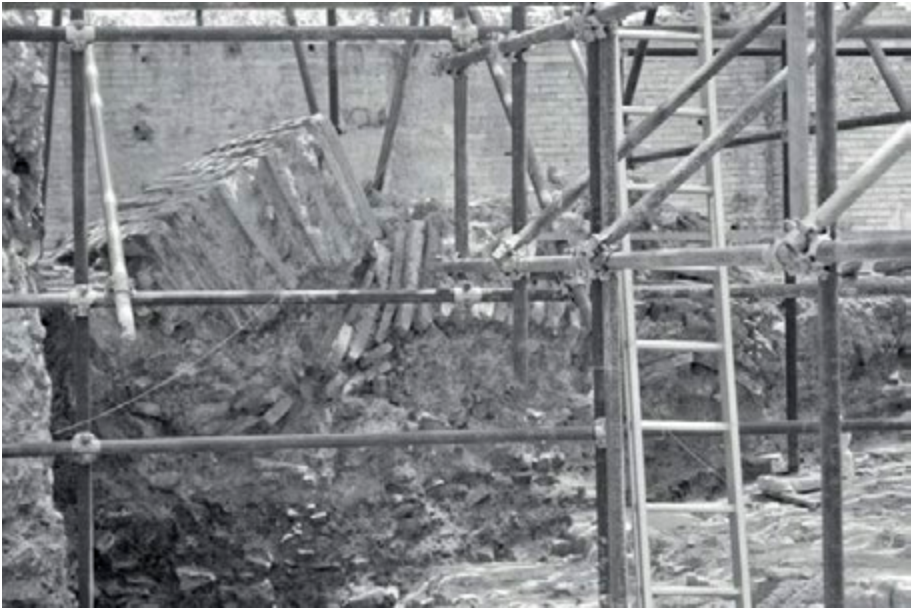
Fig. 53. Restos de los arcos derrumbados en el Aula B.
