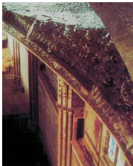
Fig. 6. Assisi, Basilica Superiore di San Francesco: la sezione di un crollo, dove è visibile il riempimento incoerente sopra le volte (da Giandomenico, Rocchi, Il Sacro Convento , p. 93, fig. 2).
