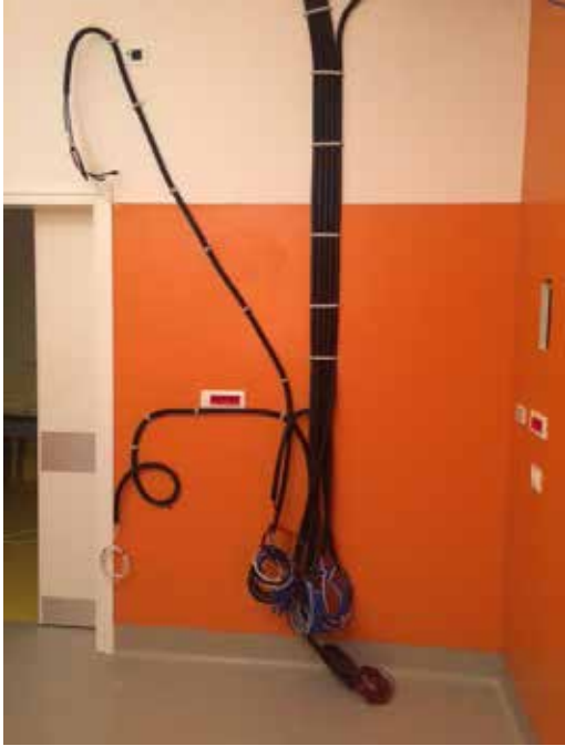
Figura 13. Colonna montante degli impianti elettrici.
