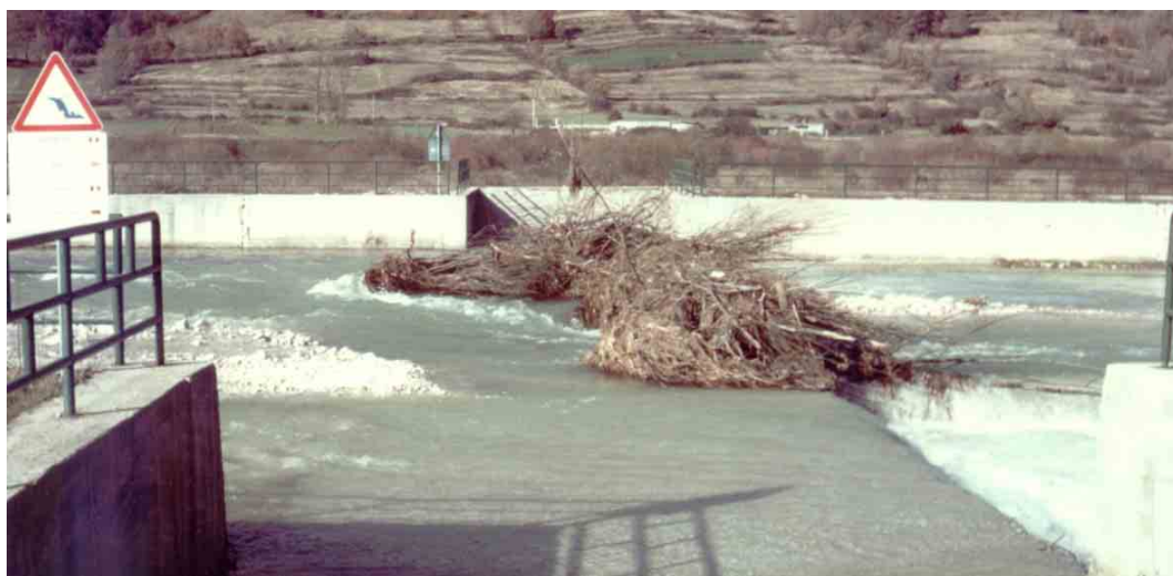
Figure 1-2. Esempi di (stra)ordinario degrado (fiume Sangro, Abruzzo).
