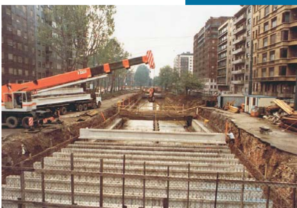
Figura 123 Rifacimento della copertura del cavo Redefossi in via Monte Santo, Milano, Archivio Storico F.C.A.
