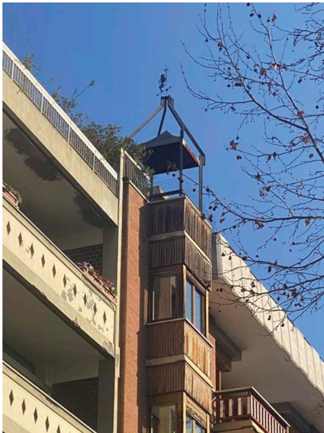
Figura 16 – G.K. Koenig, C. Messina, condominio di via XX Settembre, Firenze, 1967, particolare della torretta con gazebo. [Foto F. Pozzolini]
