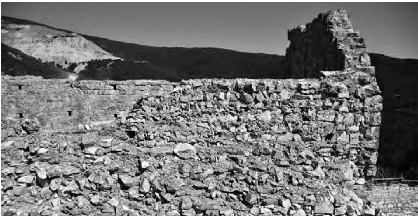
Figura 2 UT 4, chiesa, particolare di un palinsesto privo di giunti di malta di allettamento
