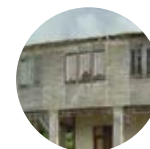
A45 Casa del Historiador Guanabo Estado general I Calidad arquitectónica II S11
